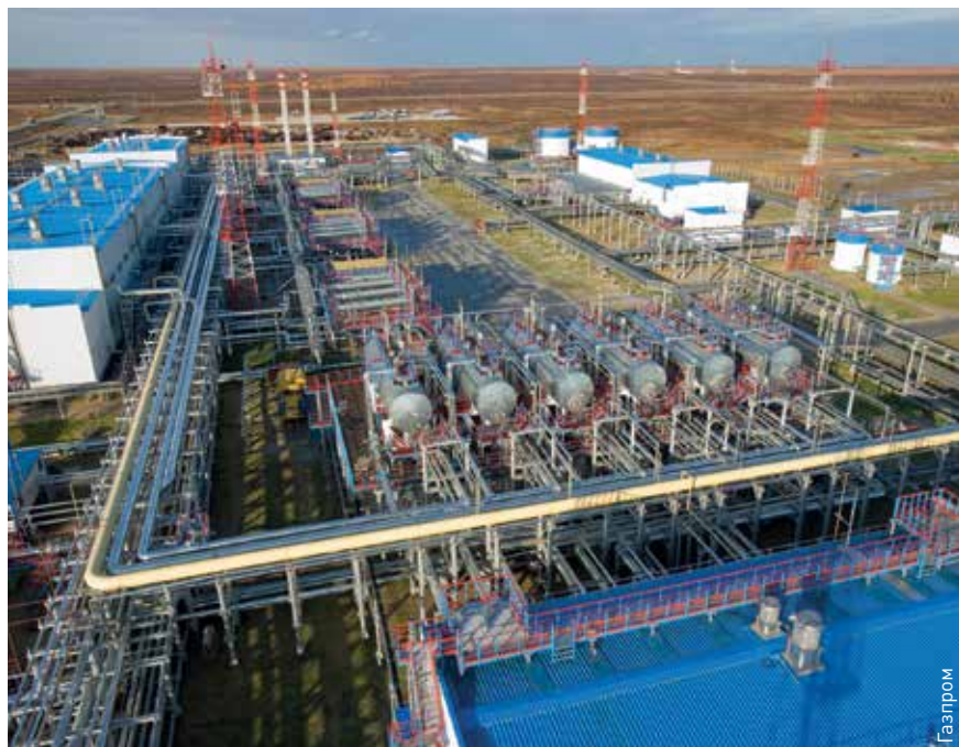
Установка комплексной подготовки газа № 22 на участке 2А ачимовских отложений Уренгойского месторождения
